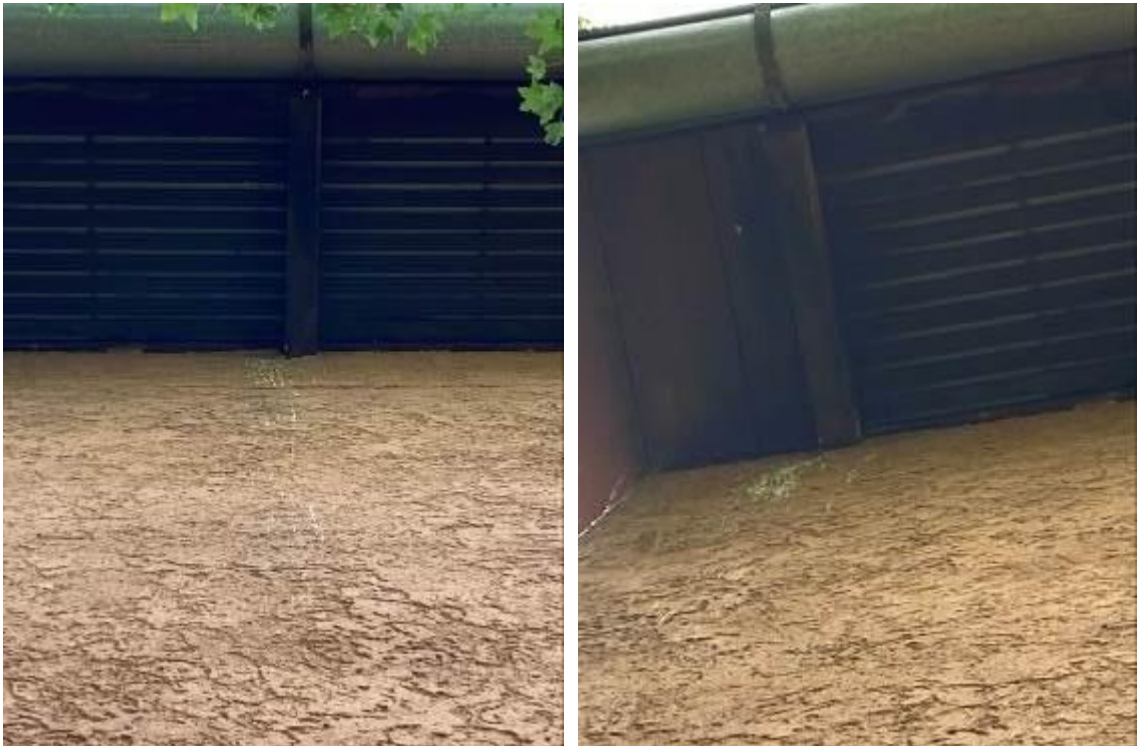
Abbildung 6: Vogelkot an der Nordseite der Turnhalle
